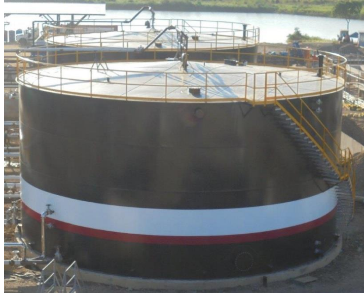
Figura 15. Tanques de almacenamiento
