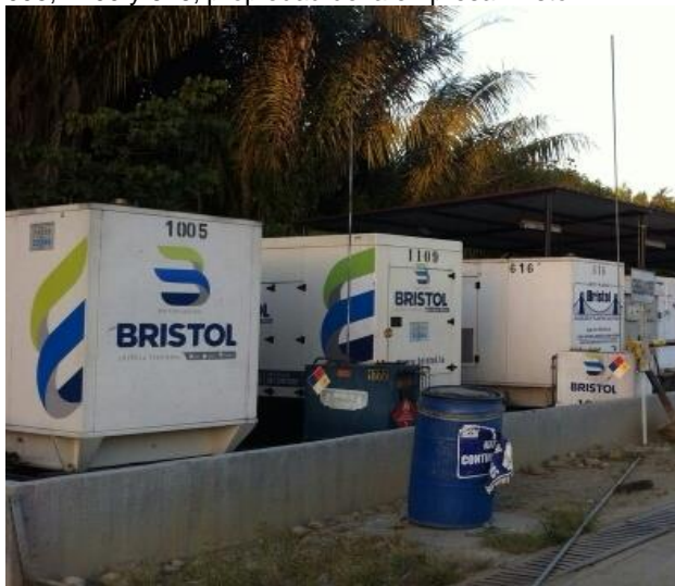
Figura 25. Generadores 1005, 1109 y 616, propiedad de la empresa Bristol.
