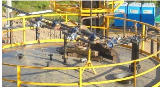
Figura 18. Cabezal de baja TK-TU-202A
