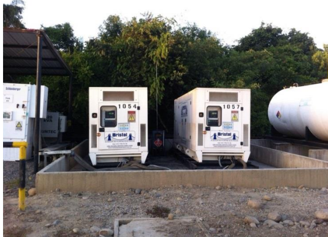
Figura 26. Generadores 1054 y 1057, propiedad de la empresa Bristol.
