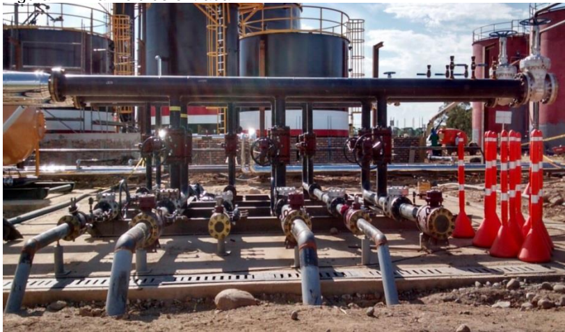
Figura 11. Manifold de entrada
