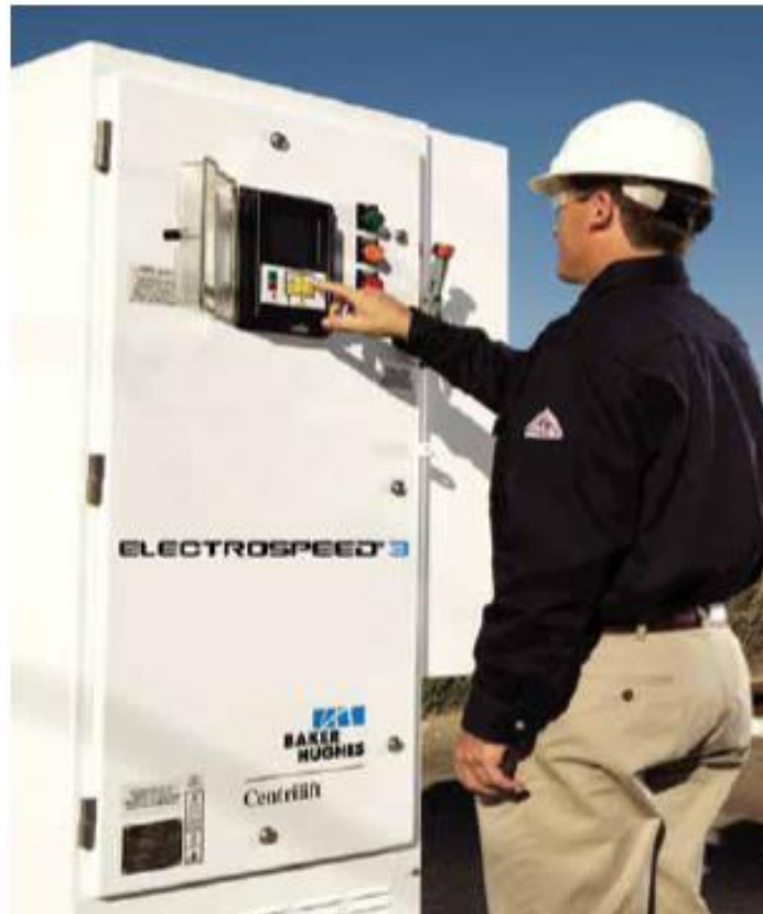
Figura 4. Variador de frecuencia
