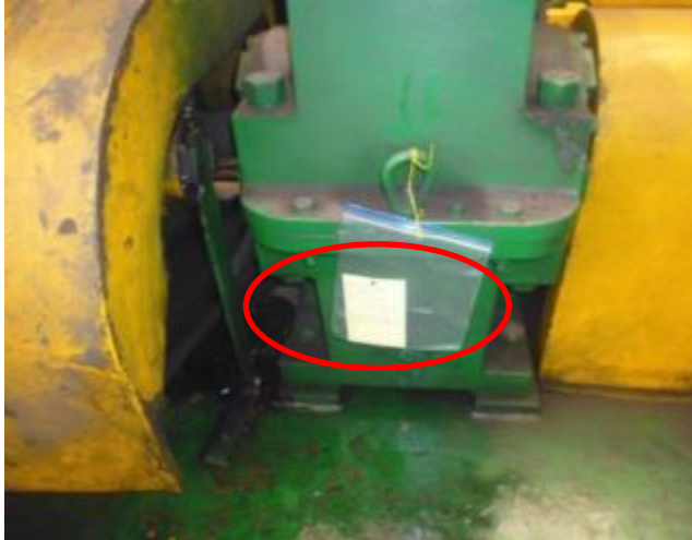
Figura 33. Eliminación de fugas y derrames, situación antes.
