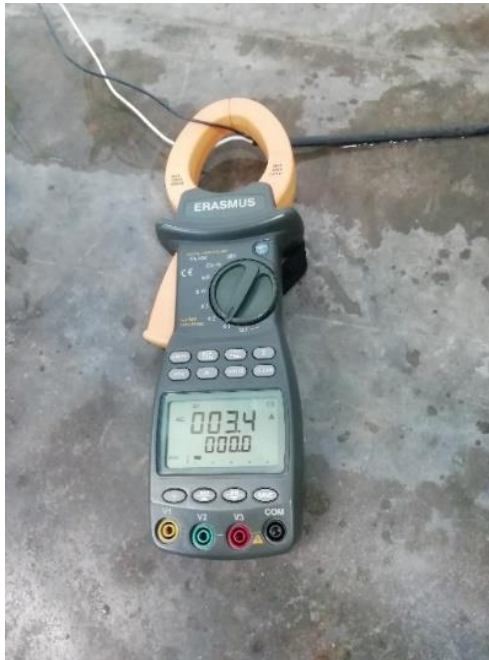
Figura 35. Pinza digital de energía trifásica, ERASMUS en medición de corriente de la torre.
