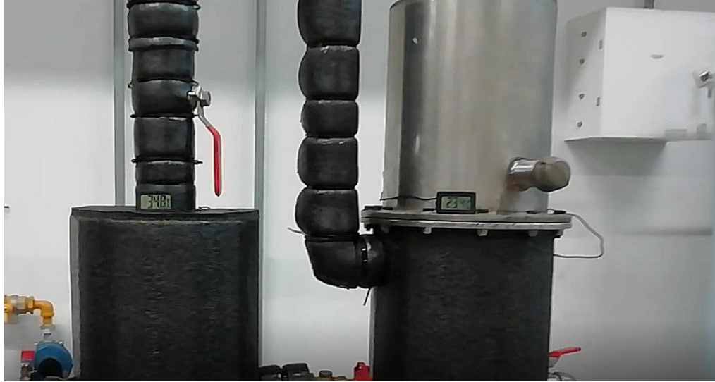
Figura 22. Aislante térmico y sensores de temperatura.
