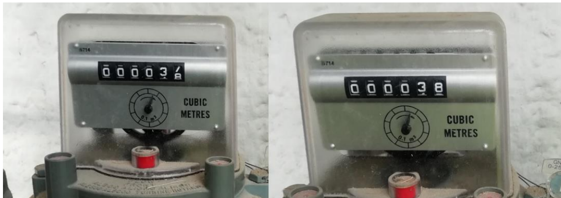
Figura 36. Variación en el registro de gas natural de la Escuela de ingeniería mecánica al iniciar y finalizar la prueba.
