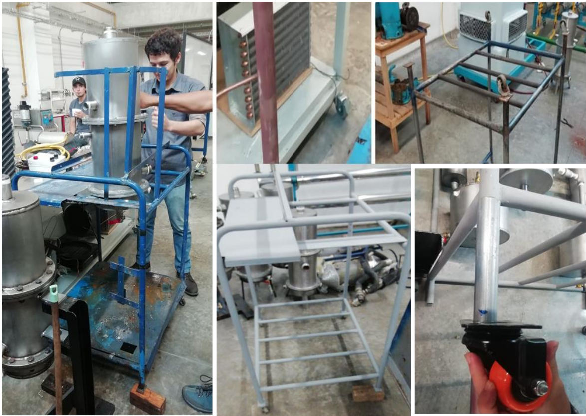
Figura 15. Estructura acondicionada para funcionar como bastidor del sistema.
