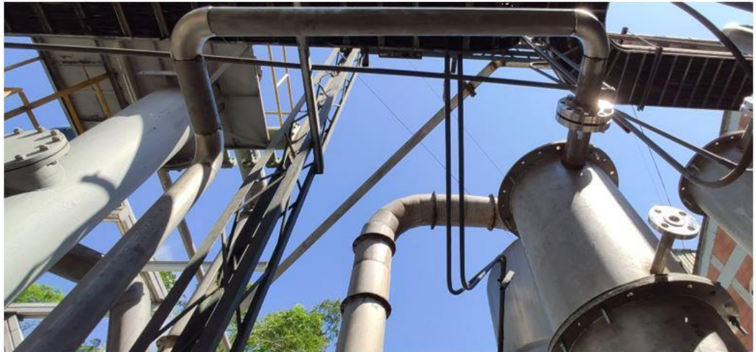
Figura 40. Conexión segundo evaporador y condensador
