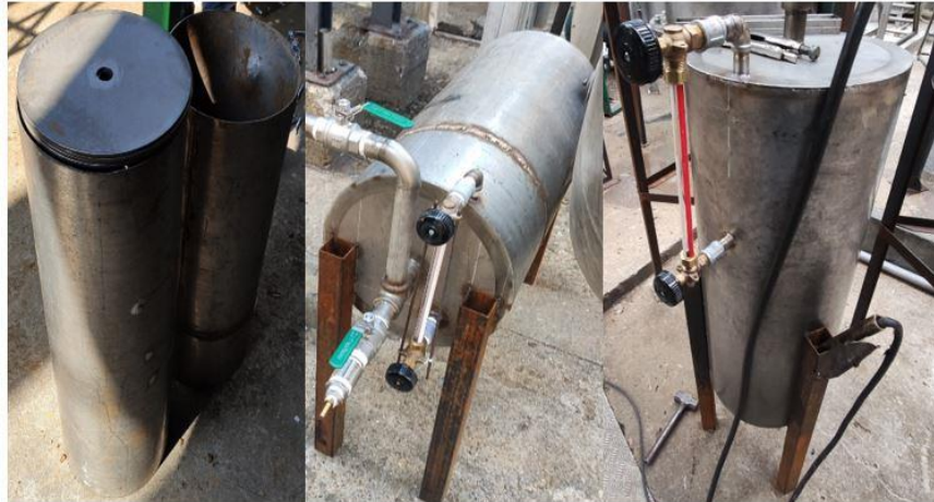
Figura 36. Ubicación de tanques de condensado en sitio.
