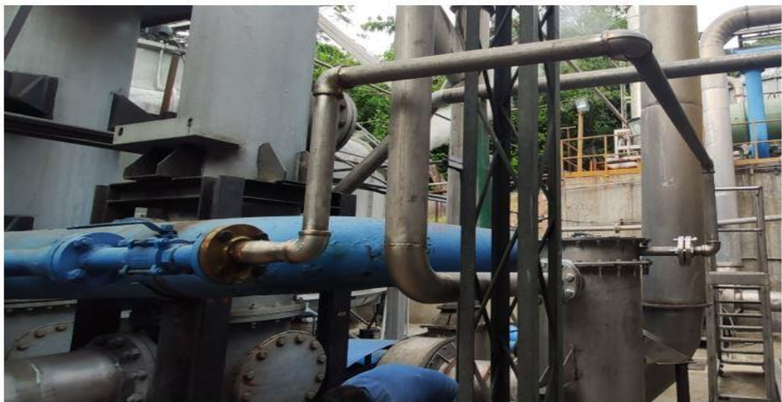
Figura 42. Conexión entre torre y condensador (agua fría).
