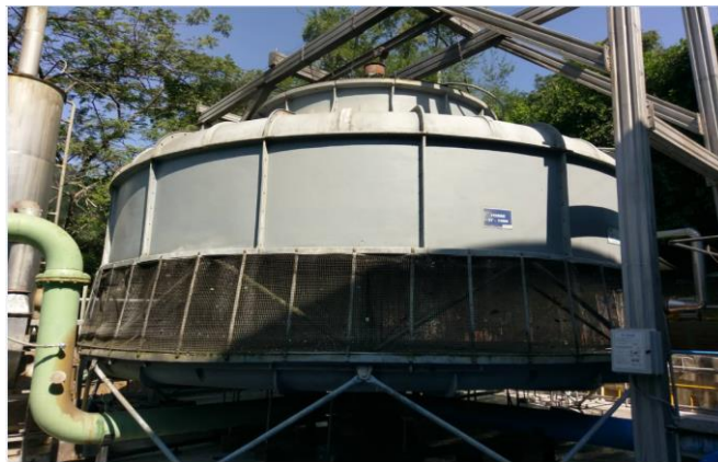
Figura 9. Torre de enfriamiento acoplada al condensador.
