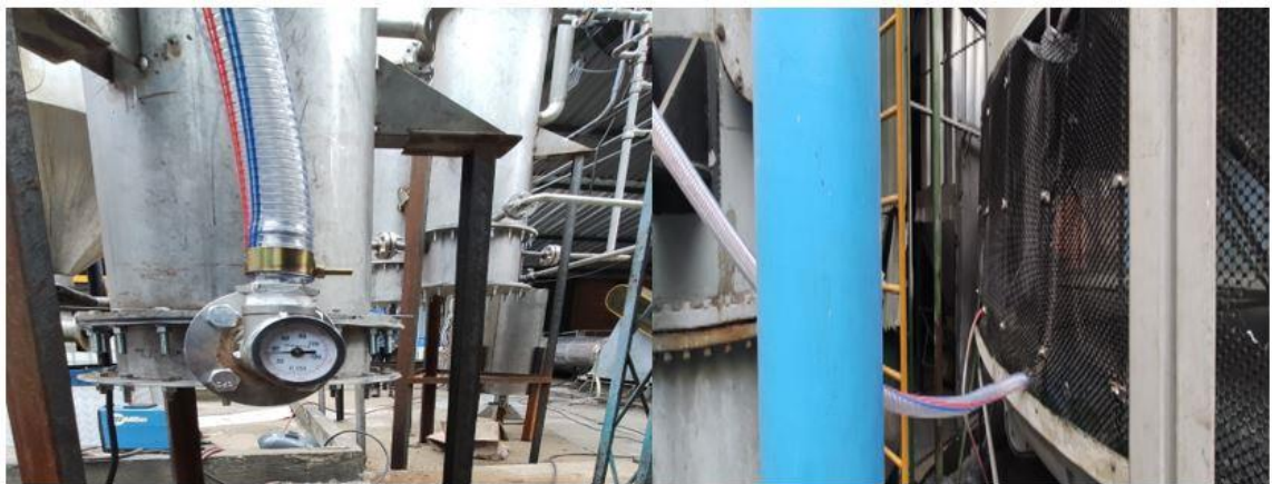
Figura 43. Conexión entre torre y condensador (agua caliente).
