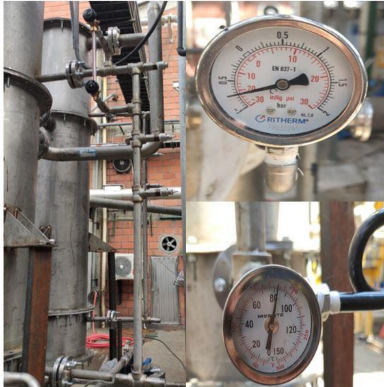
Figura 45. Instrumentalización de los evaporadores.
