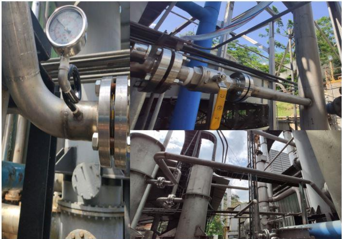
Figura 38. Conexión del vapor residual.
