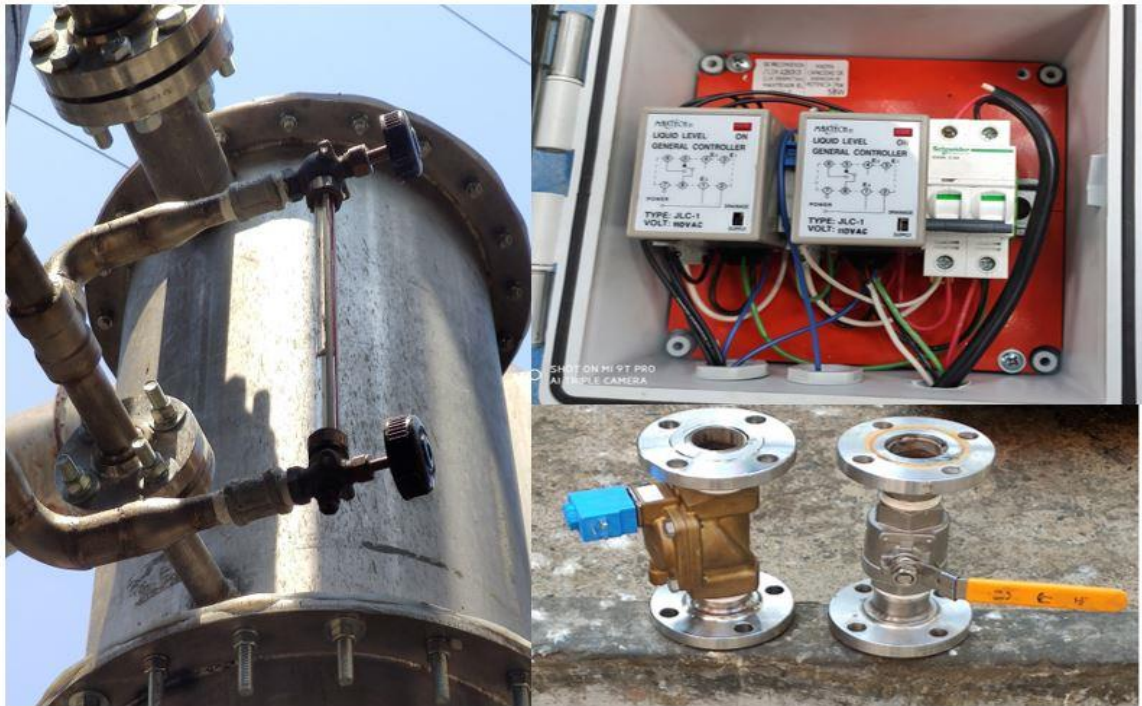
Figura 52. Controlador de nivel.
