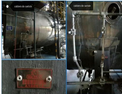
Figura 2. Caldera principal de la planta de harinas de Avidesa Mac Pollo S.A.
