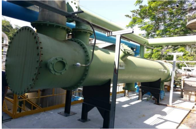
Figura 8. Condensador de vapor de desecho utilizado actualmente.
