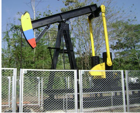
Figura 31. Foto de la unidad de bombeo mecánico
