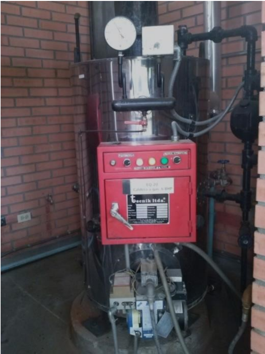
Figura 26. Caldera que proporciona el vapor para la destilación, instalada en el CENIVAM-UIS.
