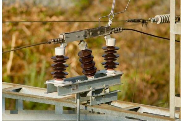
Figura 8. Aisladores en material de cerámica
