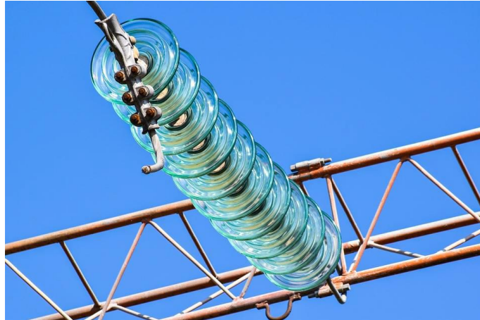
Figura 9. Aisladores en material de vidrio
