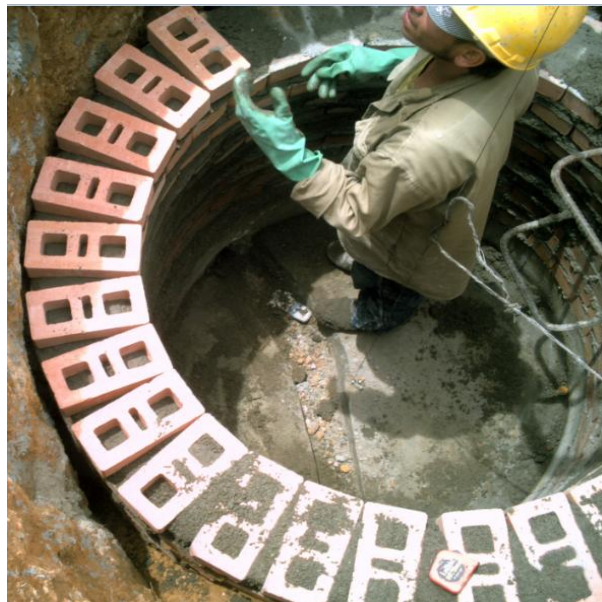
Fotografía 2. Pozo de inspección con ladrillo Temosa no permitido.
