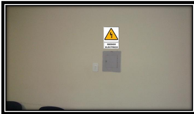
Señal riesgo electrico salón audiovisuales.
