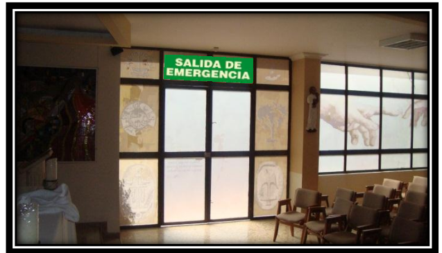
Señal salida de emergencia puerta capilla.
