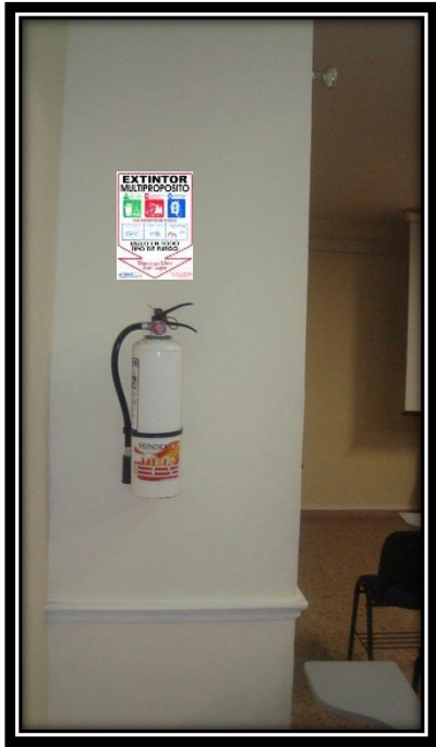
Señal extintor audiovisuales
