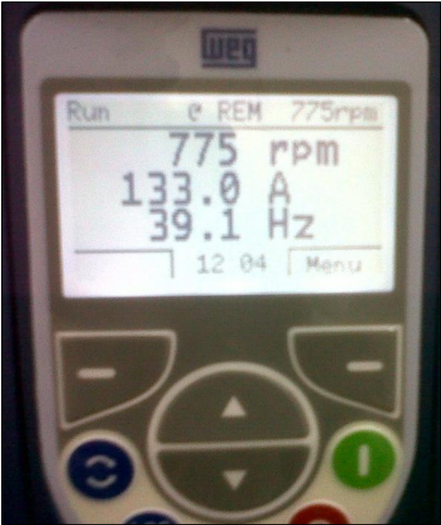
Anexo B. Panel del Variador de Frecuencia.
