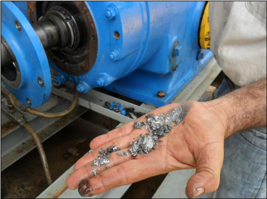
Anexo G. Daño de la base del rodamiento.
