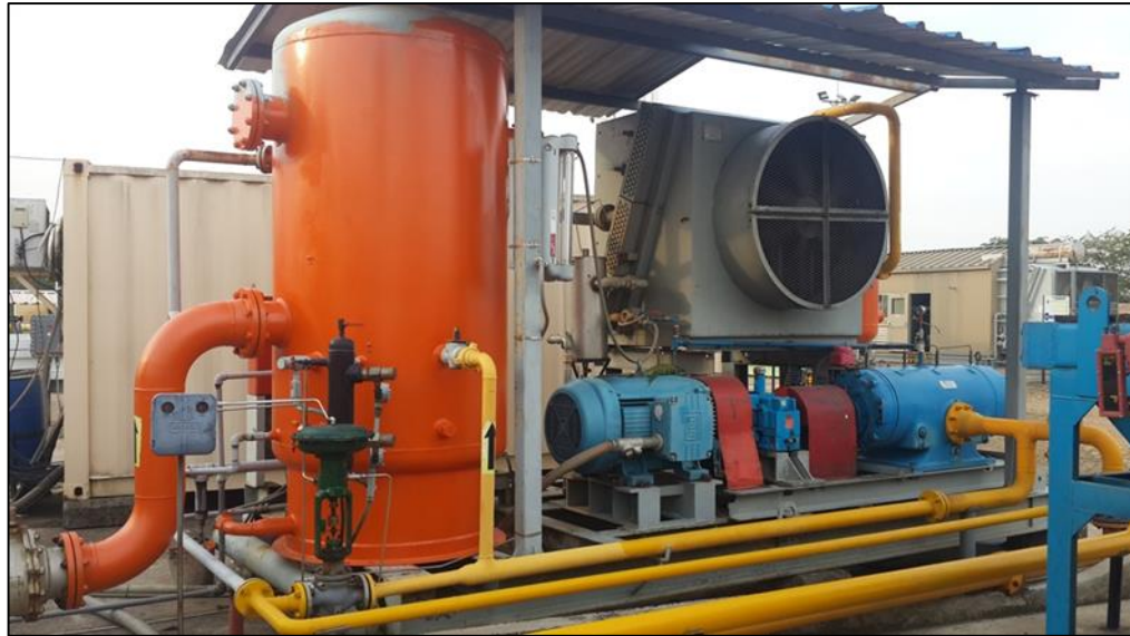
Figura 4. Unidad Recuperadora de Vapores.
