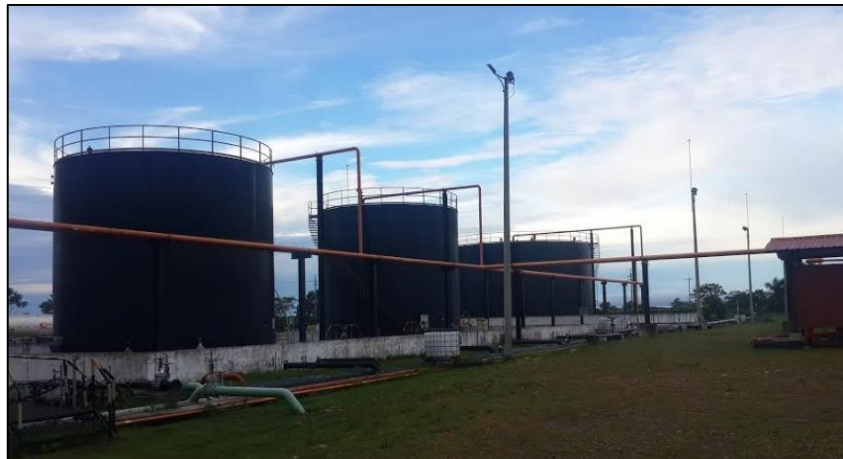
Figura 12. Tanques de Almacenamiento Campo La Punta.
