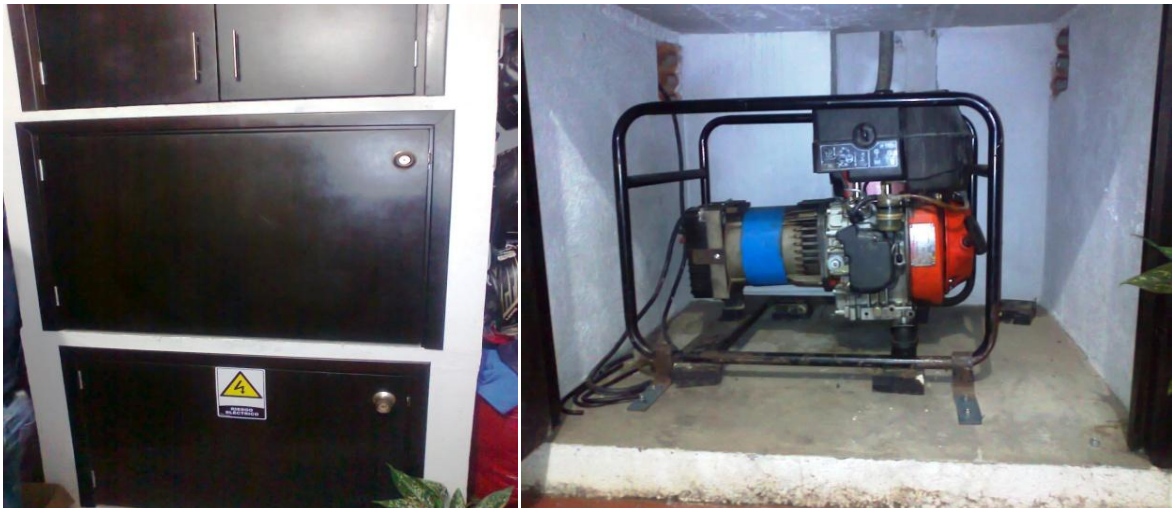
Figura 10. Coraza aislante de la planta eléctrica
