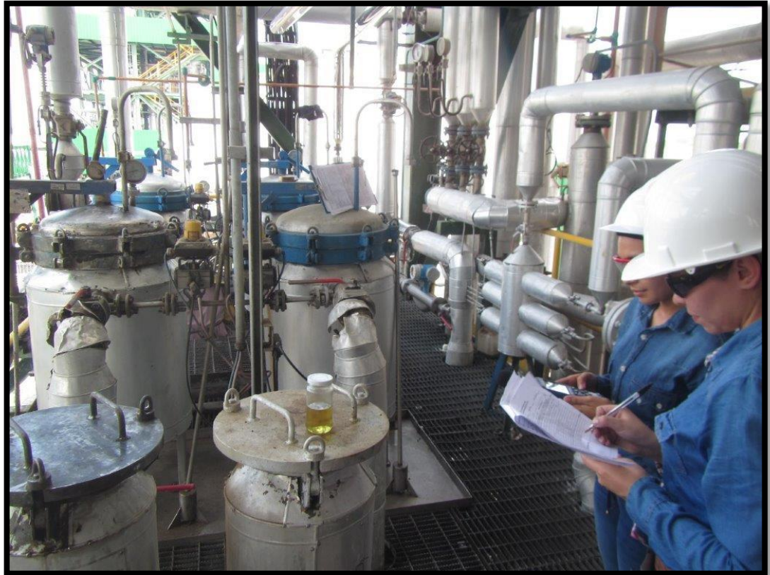
Fotografía que muestra una toma de medición de ruido en el blanqueador de la planta Ecodiesel.
