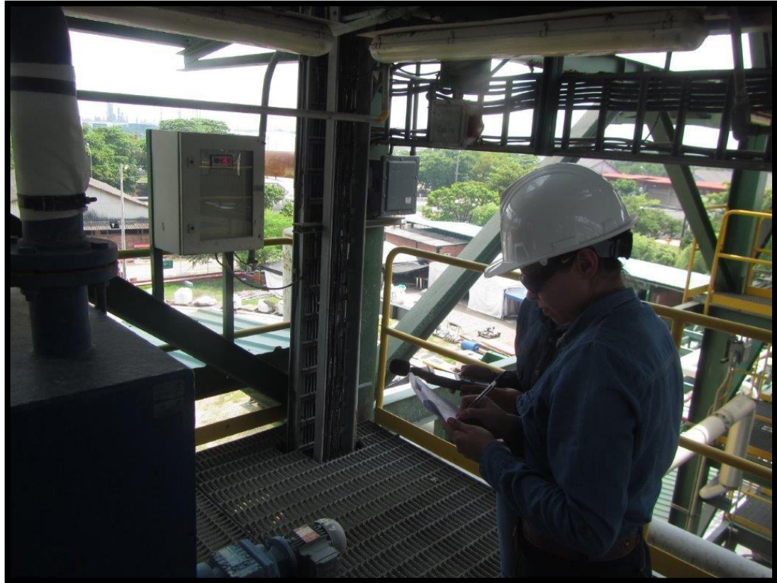
Fotografía que muestra una toma de medición de ruido en el filtro 6-16 de la planta Ecodiesel.
