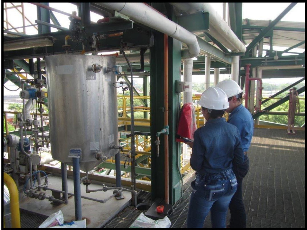
Fotografía que muestra una toma de medición de ruido en el agitador Mg503 de la planta Ecodiesel.
