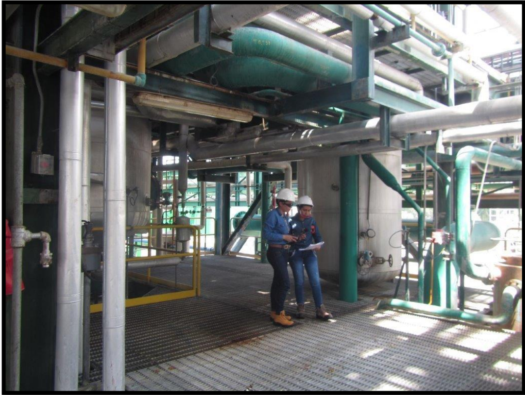
Fotografía que muestra el análisis de las mediciones de ruido de la planta Ecodiesel.
