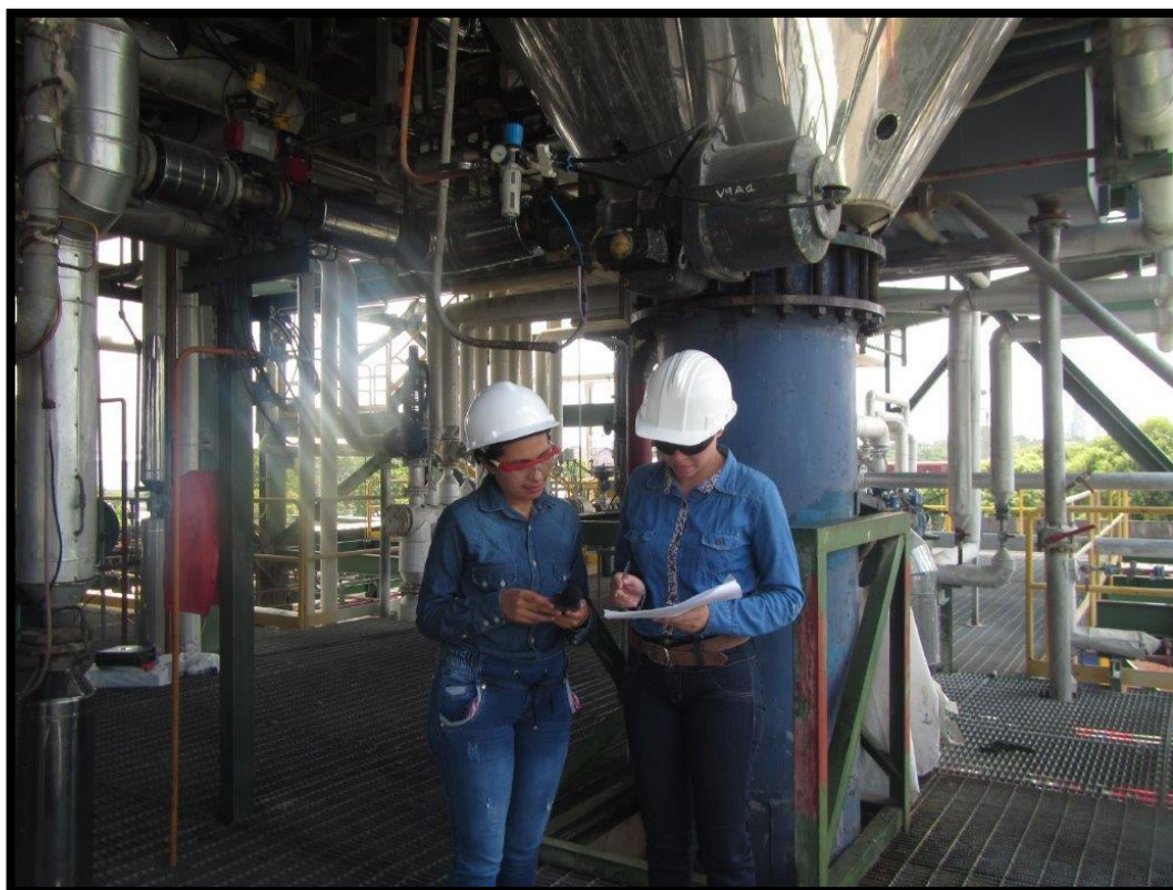
Fotografía que muestra el análisis de las mediciones de ruido del tercer piso de la planta Ecodiesel.
