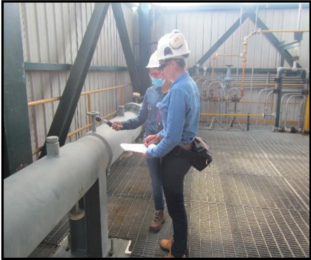
Fotografía que muestra una toma de medición de estrés térmico en la columna 163-C1 de la planta Biodiesel.
