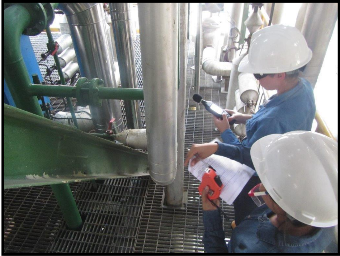
Fotografía que muestra una toma de medición de ruido en el intercambiador de calor 8-81 de la planta Ecodiesel.
