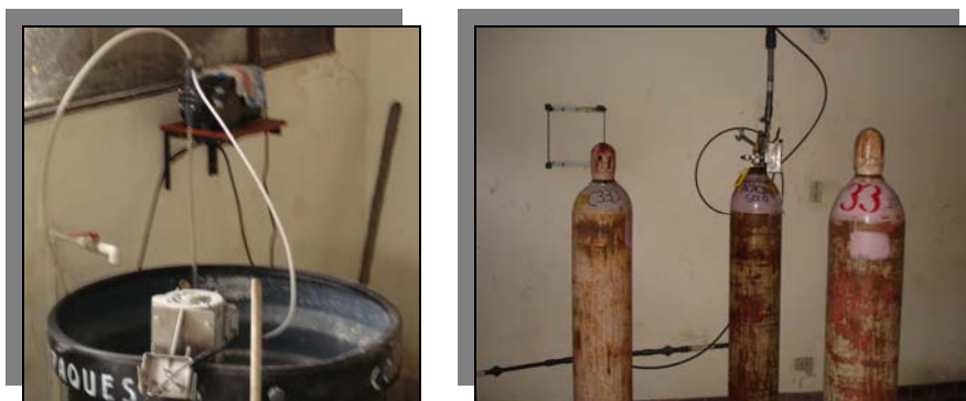
Figura A13. Equipos para dosificar álcali y cloro
