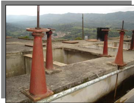
Figura A11. Batería de filtros rápidos
