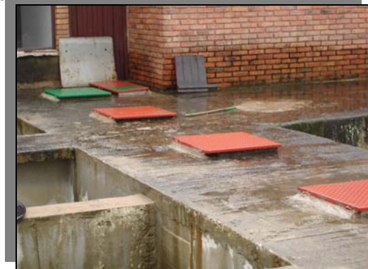
Figura J5. Adecuación de tapas
