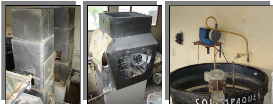
Figura A12. Equipos para dosificar sulfato, cal y policloruro
