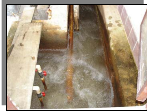
Figura A7. Estructura de admisión de agua
