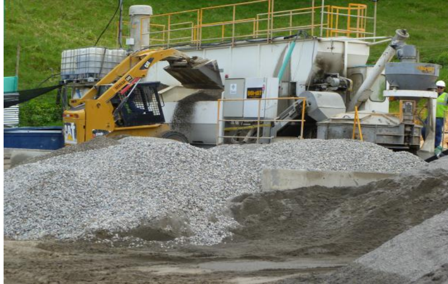
Figura 16. Planta de concreto
