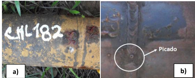
Figura 13. Defectología en cordones de soldadura (tubería colectora). a) Focos de corrosión en todo el perímetro y b) picado sobre el cordón
