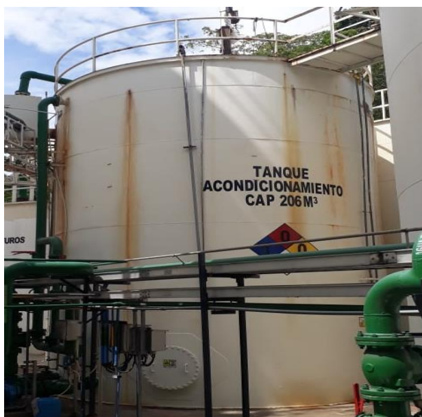
Figura 13. Tanque de acondicionamiento TA 01
