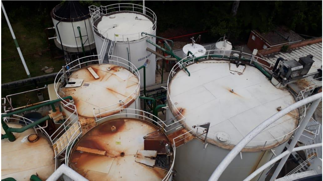
Figura 15. Vista aérea tanques planta PTAR
