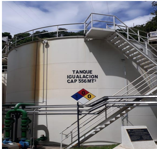
Figura 12. Tanque de Igualación TI 01 PTAR
