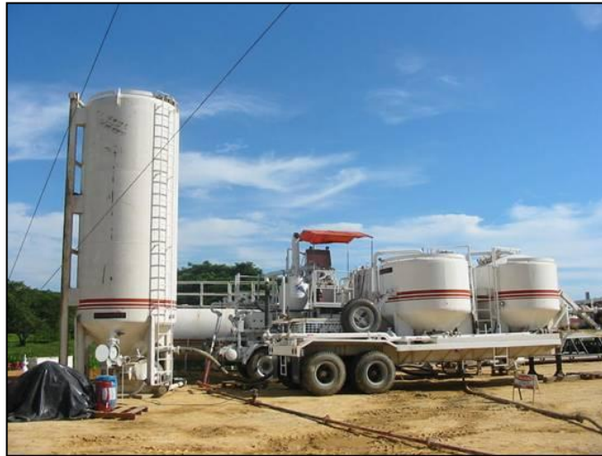
Fotografía 2. Equipo de cementación tipo utilizado en perforación.
