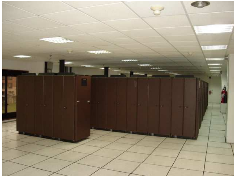
Figura 6. Central de conmutación
