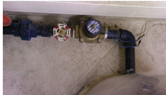
Figura 10. Válvula de desagüe. Fuente: Autores.
