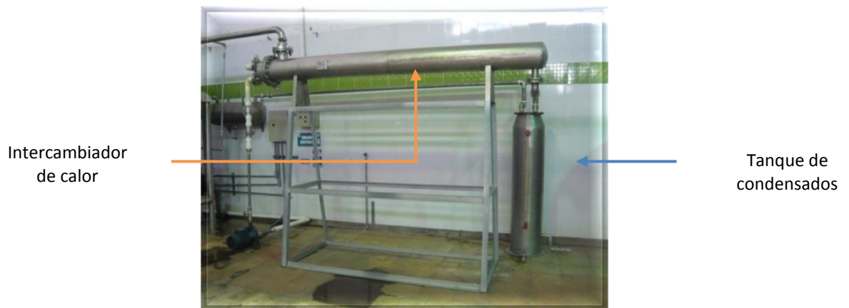
Figura 15: Intercambiador de calor
