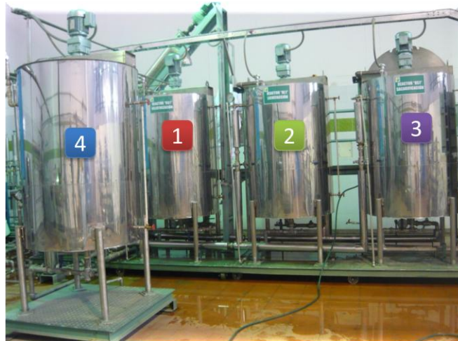
Figura 10: Reactores de la planta de producción
