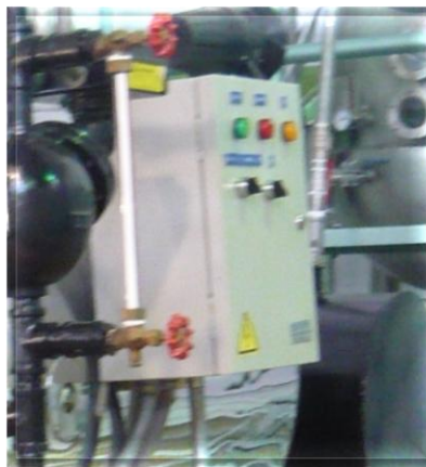
Figura 9: Caja de Control de la Caldera
