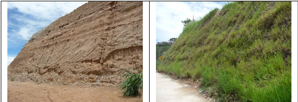
Figura 27 Izq, Talud vía sustitutiva Hidrosogamoso, Der. Talud vía Lebrija – Girón - Santander.
