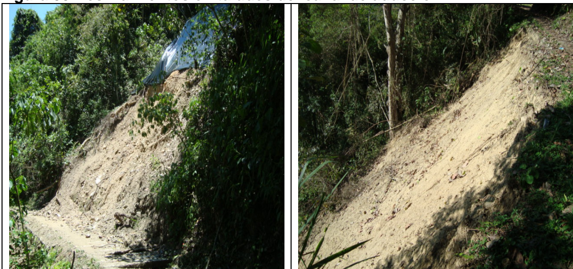
Figura 35 Deslizamientos en taludes del canal de aducción.
