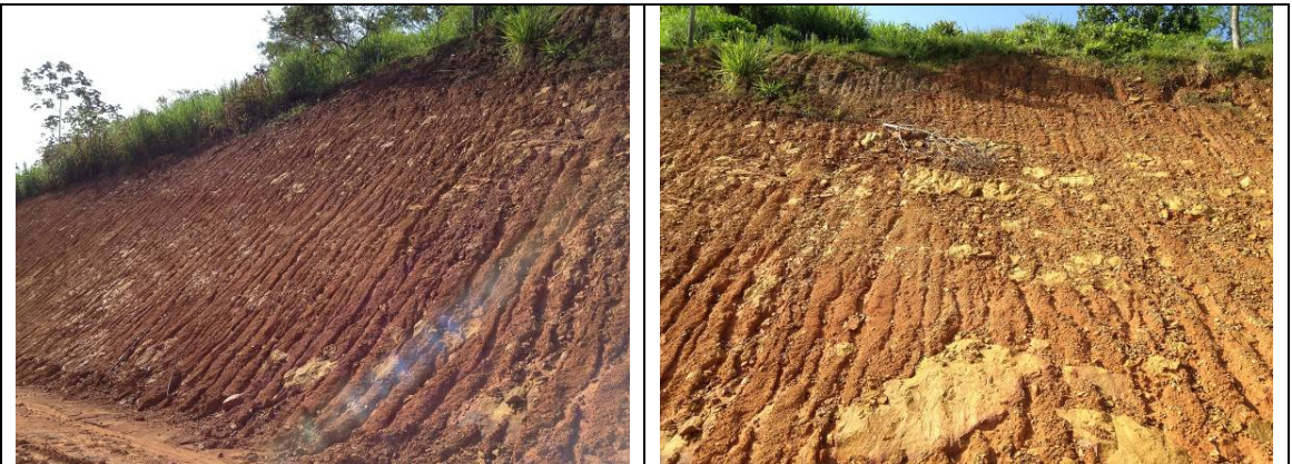
Figura 31 Erosión prematura del Talud Vía sustitutiva Hidrosogamoso - Santander.
