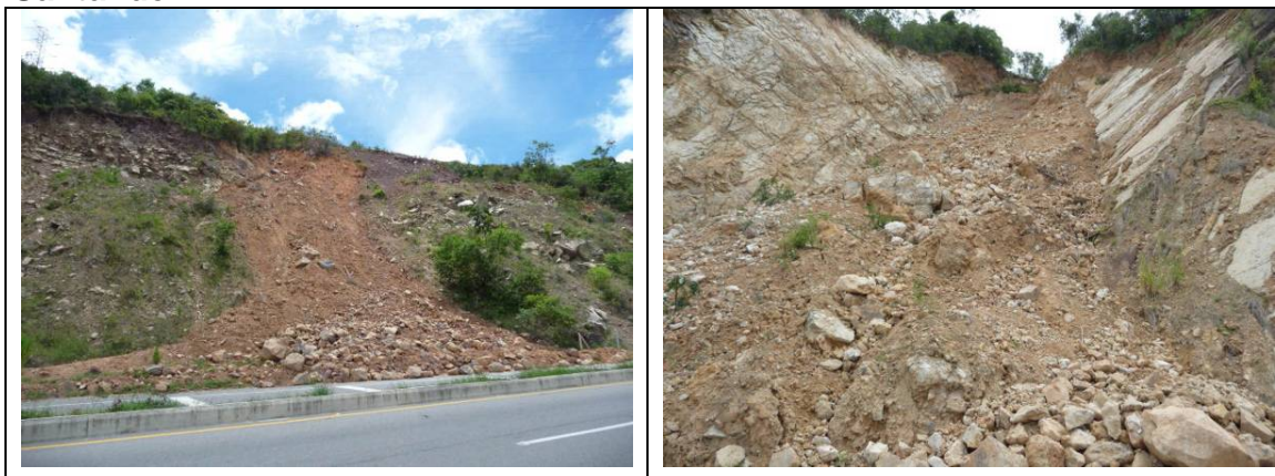
Figura 30 Taludes con deslizamientos o lavados, vía Lebrija – Giron - Santander
