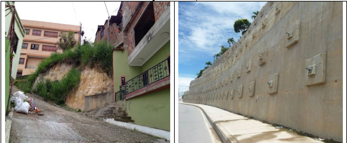
Figura 26 Talud con riesgo de deslizamiento y pérdida de vidas humanas, y estabilización con concreto. Lebrija – Girón, Santander
