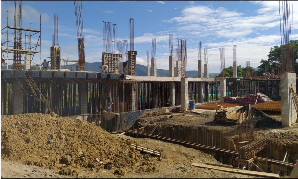
Figura 8. Avance general de obra, visita de obra realizada el 12 de mayo de 2022.
