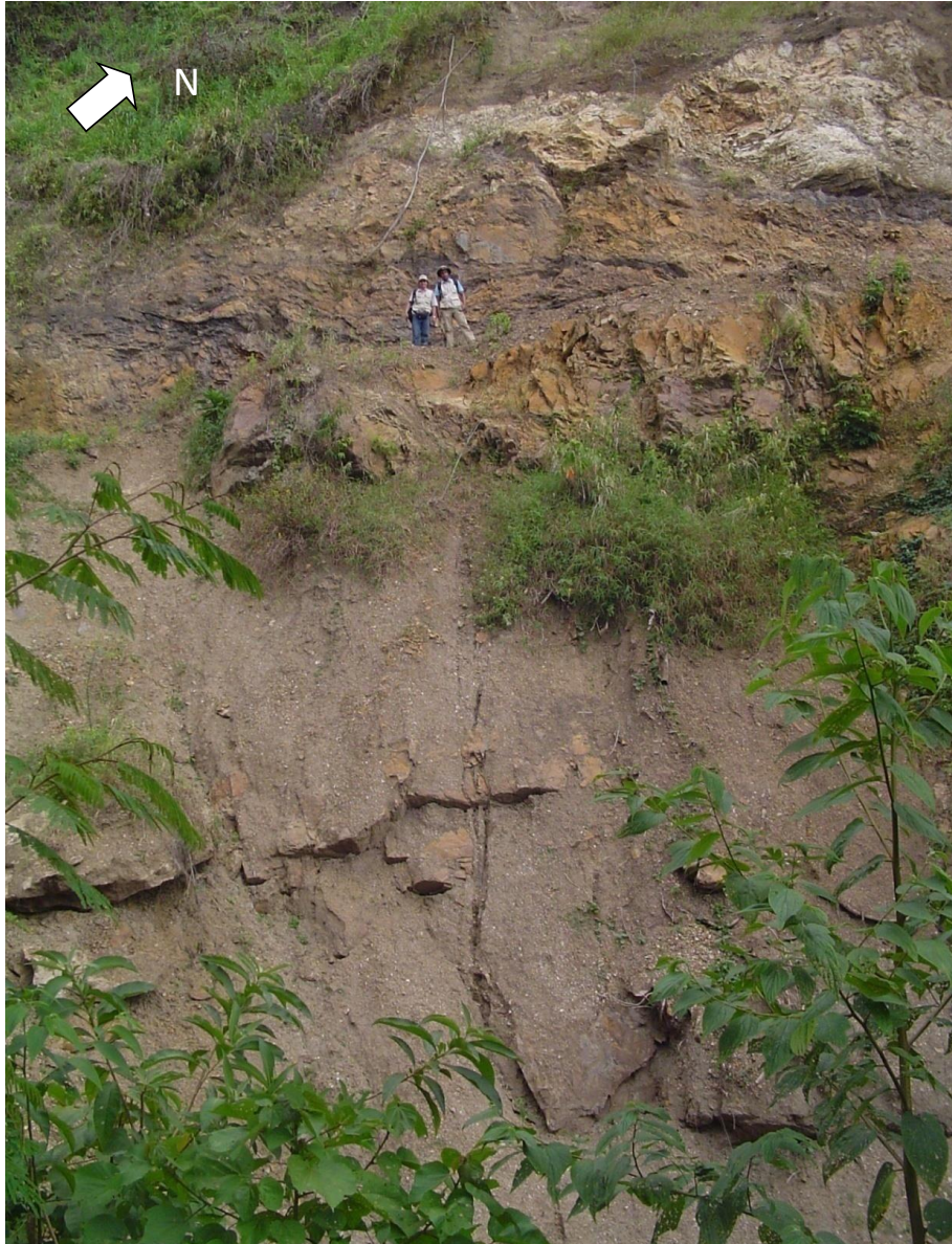
Figura 35. Movimiento en masa situado en la intersección de la vía que comunica a la vereda Jácome con la vereda el triunfo y la quebrada el Zancudo. Orientación de la fotografía: N50E.
