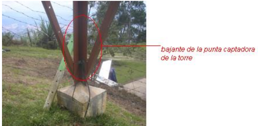
Figura 29. Bajante de la torre de comunicación.
