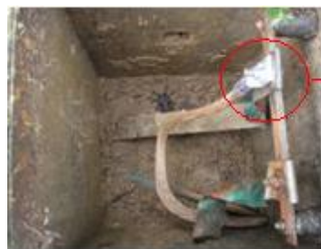
Figura 25. Puesta a tierra del transformador trifásico, equipo sensible y la planta de emergencia.
