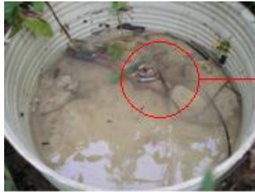
Figura 26. Electrodo de puesta a tierra del transformador trifásico, equipo sensible y la planta de emergencia.
