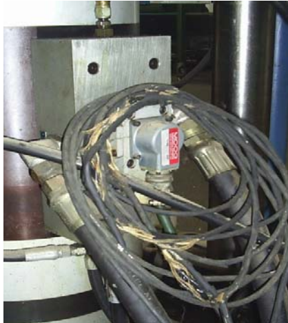
Figura 102. Deterioro en cables
