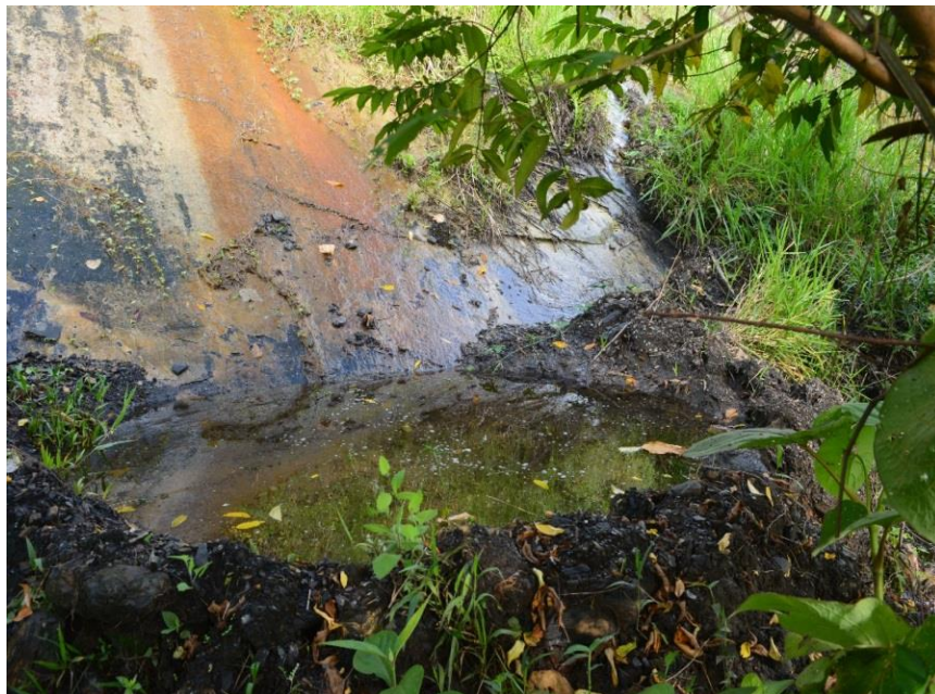
Figura 7. Agua empozada en el talud superior de la vía
