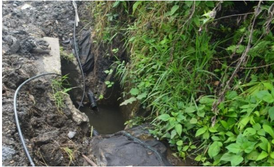
Figura 9. Encole de la alcantarilla k25+030
