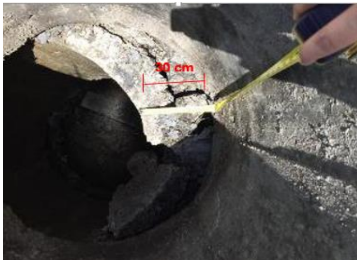
Figura 4. Descuadre de anillos de concreto para caissons
