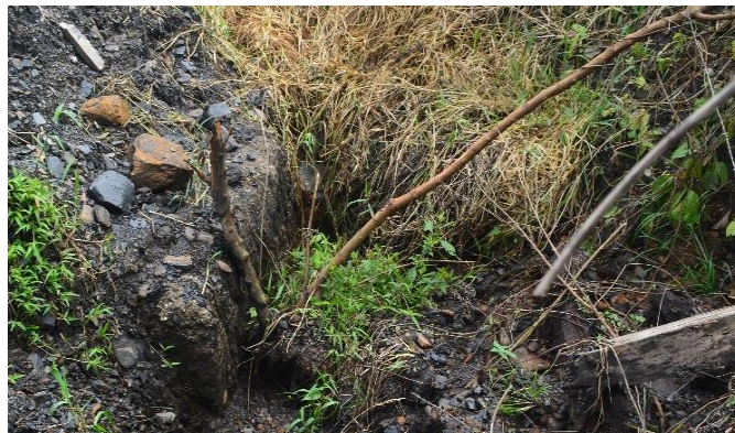
Figura 11. Encole de la alcantarilla k26+197
