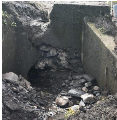
Figura 10. Encole de la alcantarilla k26+092
