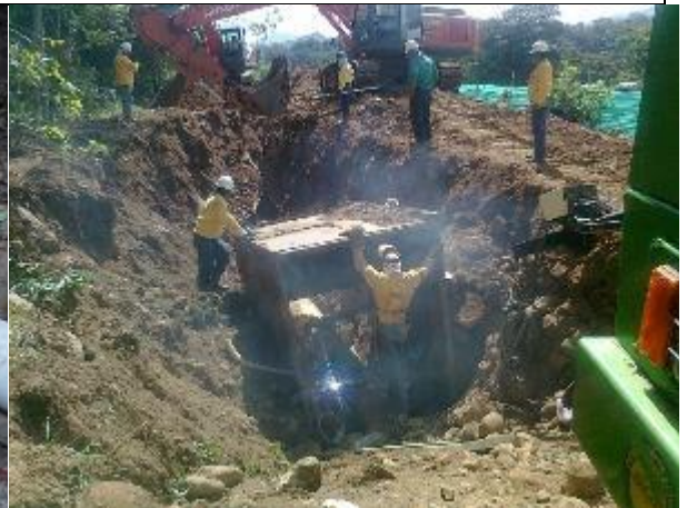
Ejecución de soldadura con mampara de protección en excavación profunda y terreno inestable.
