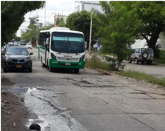
Figura 5. Evidencia fotográfica del estado actual de la vía, calle 71 con carrera 24
