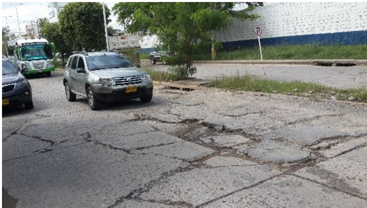
Figura 6. Evidencia fotográfica del estado actual de la vía, calle 71 con carrera 21
