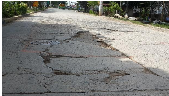
Figura 4. Evidencia fotográfica del estado actual de la vía, calle 71 con carrera 19
