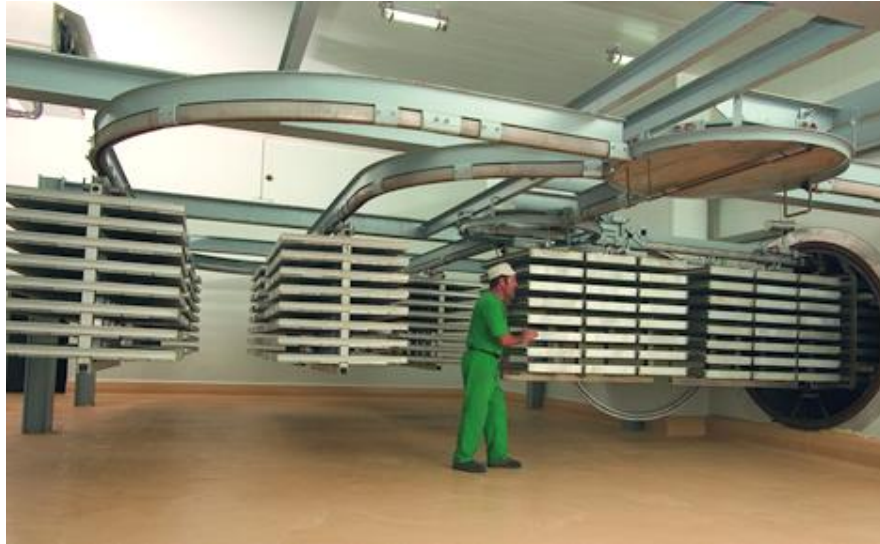
Figura 16. Instalación industrial de un liofilizador discontinuo
