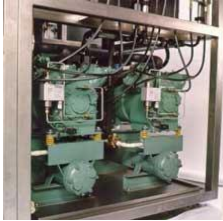
Figura 15. Detalle compresores de doble etapa.
