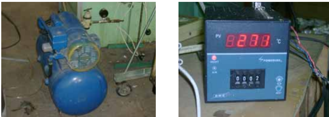
Figura 19. Compresor y termocupla
