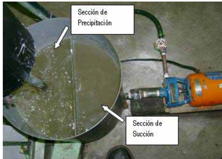
Figura 16. Tanque de lechada
