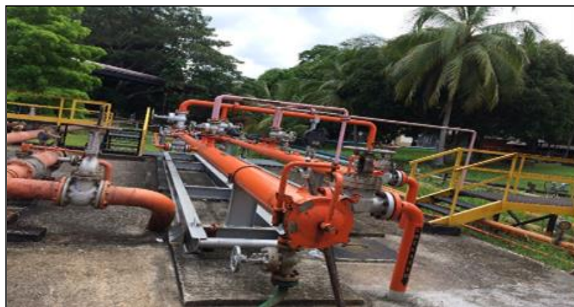
Figura 14. Punto de entrada de la corriente de gas Lisama.
