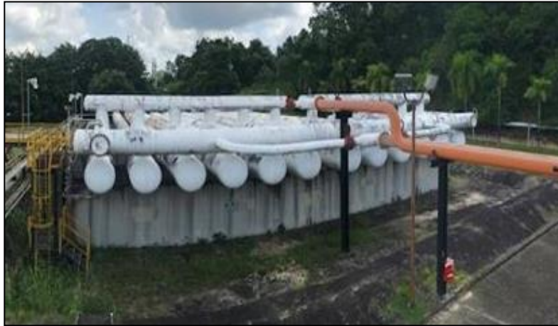
Figura 18. “Slug Catcher” de entrada de la corriente de gas Opón.
