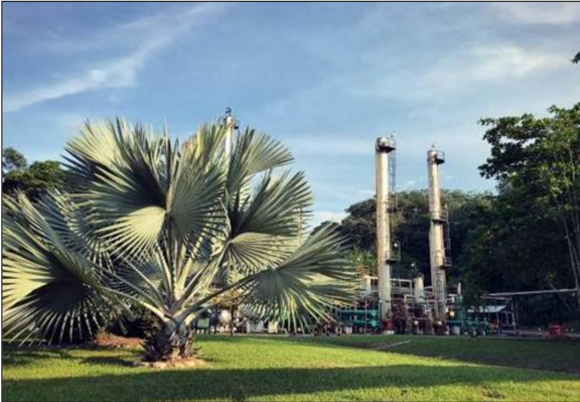
Figura 10. Planta de proceso de gas El Centro.
