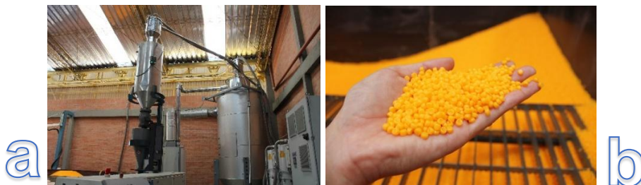
Figura 22: a) Zona de Silos – b) Tolva, detalle de Materia Prima (PELLETS)
