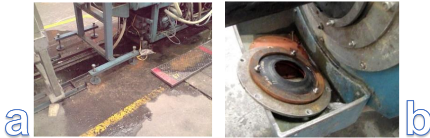
Figura 35: a) Charcos en Línea E1, -b) Accesorios acumulados en la línea
