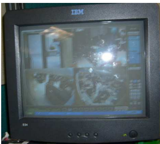
FIGURA 13: Monitor de las cámaras
