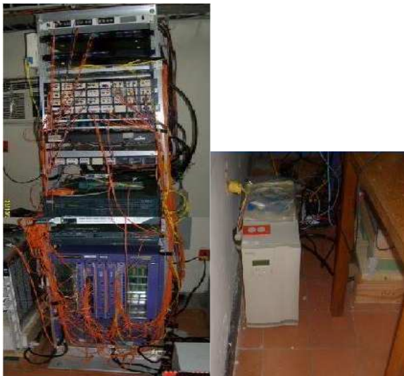
FIGURA 11: Rack principal del centro de datos
