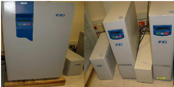
FIGURA 12: UPS del centro de datos
