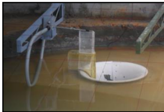
Foto 15. Anemómetro de hilo caliente localizado sobre la torre de aireación.
