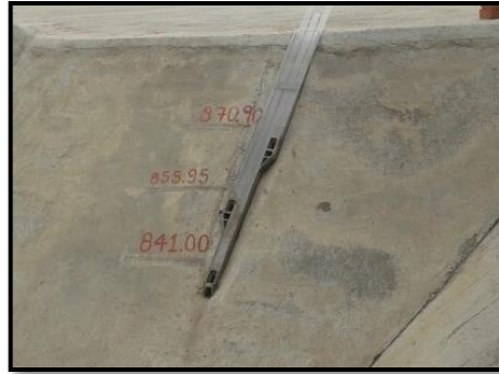
Foto 2. Sistema de Captación, por medio de 3 bocatomas.
