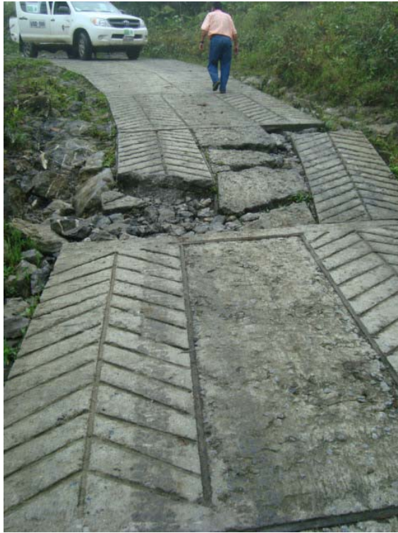
Figura 30. Caída de Banca, Severidad Alta (Vadoreal-Santa Helena del Opón).
