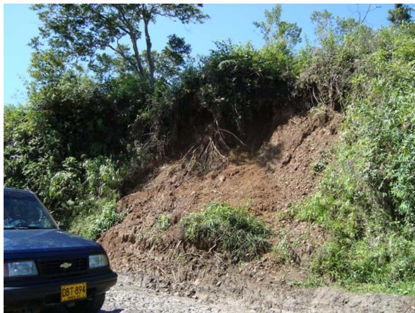
Figura 25. Deslizamiento, Severidad Baja (Puente Nacional-Florián).
