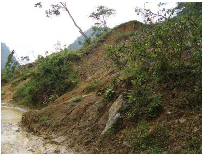
Figura 31. Deslizamiento, Severidad Alta (Puente Nacional-Florián).
