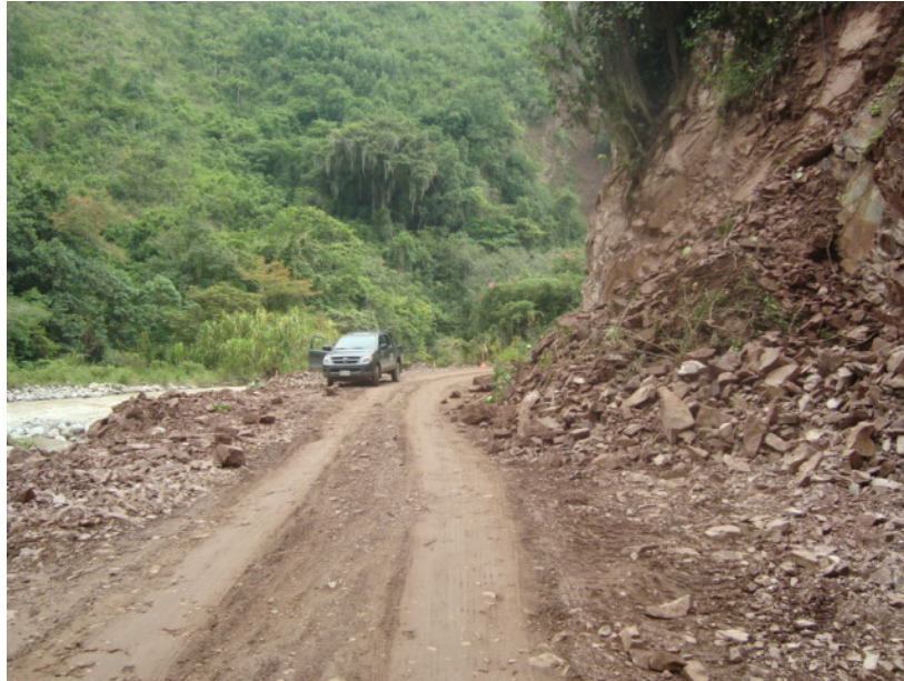
Figura 26. Derrumbe, Severidad Baja (Bucaramanga-Matanza-California).
