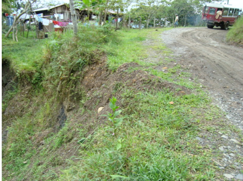
Figura 24. Caída de Banca, Severidad Baja (Vadoreal-Santa Helena del Opón).
