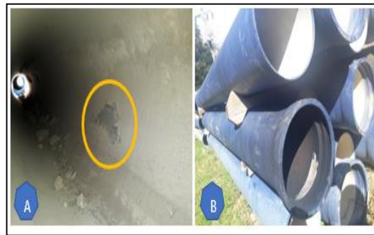
Figura 14. Registro fotográfico de tuberías en hierro dúctil.
