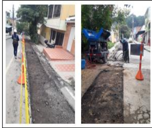
Figura 16. Actividades de corte y rotura de pavimento para obra de reposición de la conducción en el barrio Caracolí Floridablanca.
