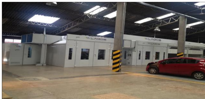
Figura 5. Cabina de pintura.
