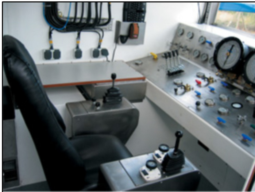
Figura 8. Cabina de control unidad moderna de TF
