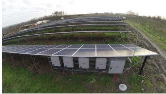
Figura 10. Paneles solares fotovoltaicos en el relleno sanitario de Mohács, Hungría. Tomado de PV Europe Recuperado de: https://www.pveurope.eu/News/Markets-Money/Fronius-offers-more-service-for-local-PV-installers-in-Hungary
