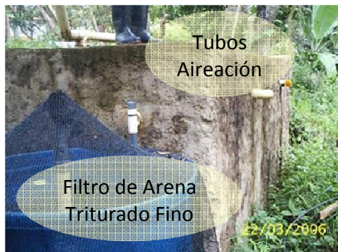
Figura 8. Vista Posterior Tanque de Tratamiento Biológico Mixto
