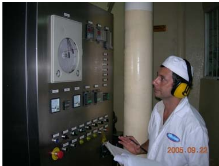
Figura 26. Revisión de los Controles del Pasteurizador.
