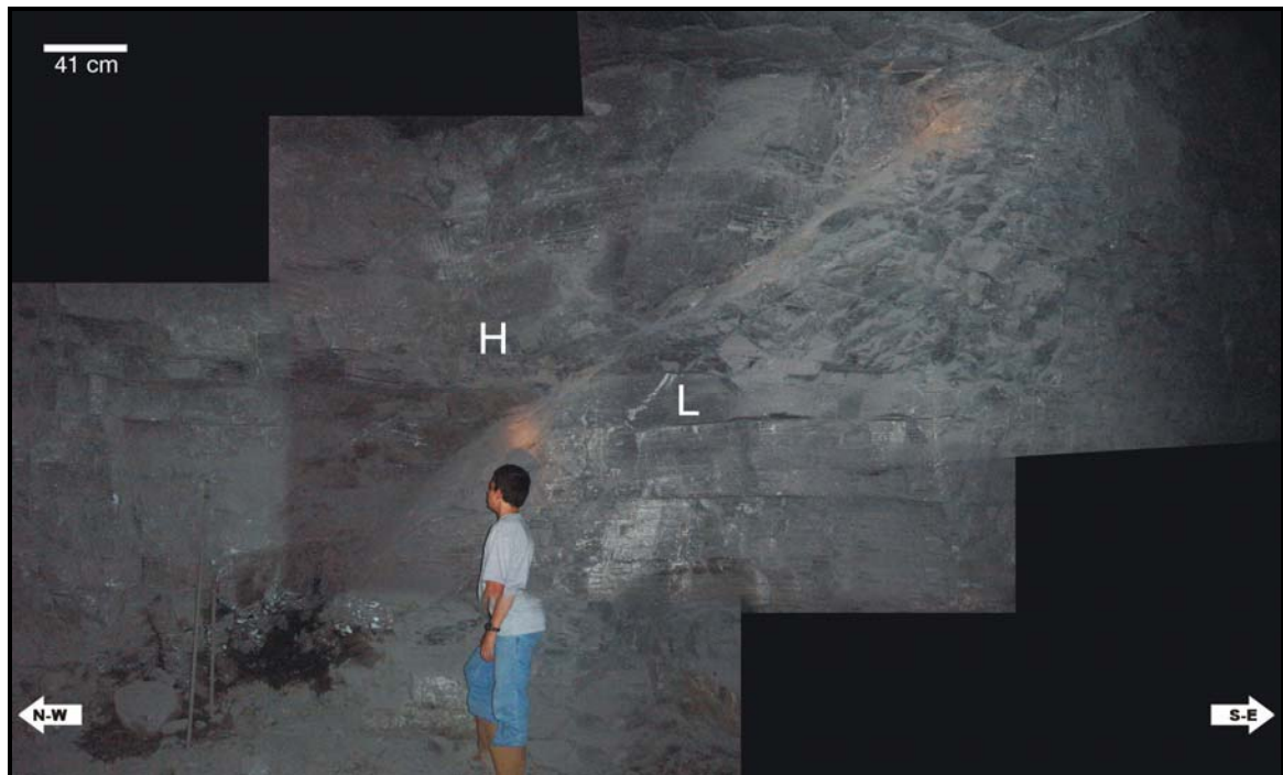
Figura 14. Imagen de la falla observada en el túnel 6 de la mina “El Carrancho” costado izquierdo del Túnel.
