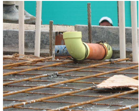
Figura 56. Desagüe de la placa
