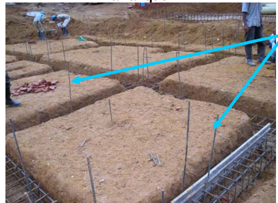
Figura 39 Bastones o refuerzos de arranque
