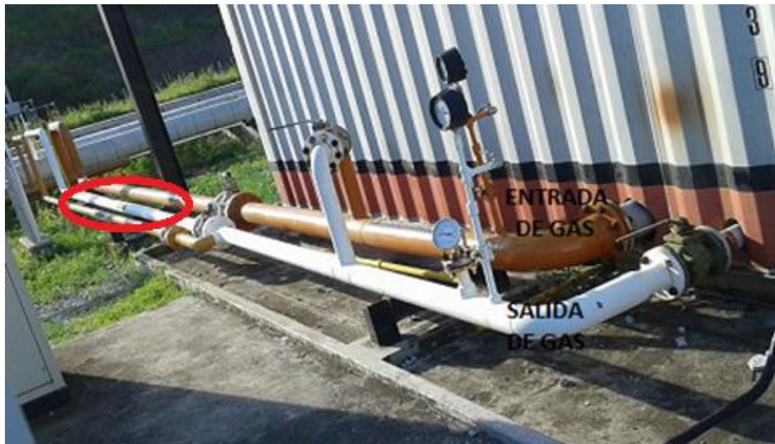
Figura 24. Línea de entrada y salida del compresor de la VRU de la ETR.
