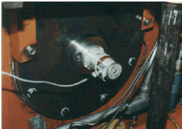
Figura 23. Instalación típica del torsio-graph.
