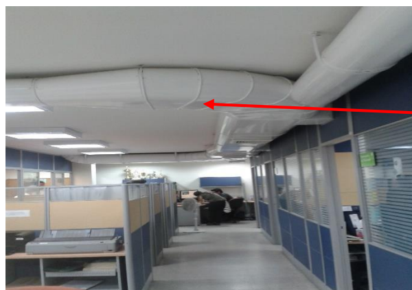
Figura 5. Tubería del aire acondicionado
