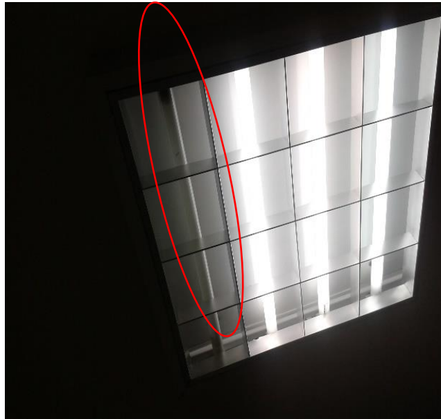
Figura 6.Luminarias en mal estado
