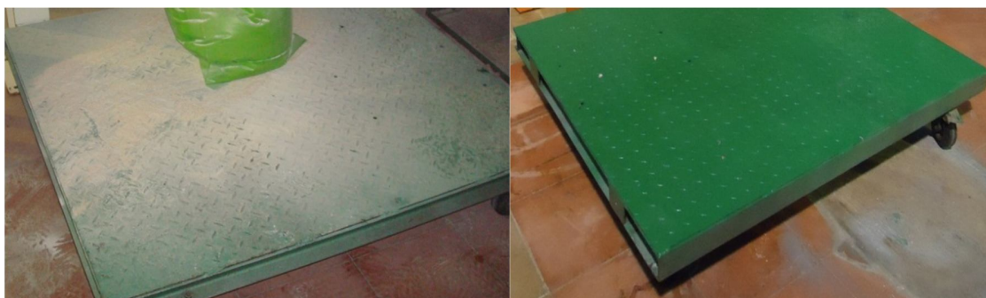
Figura 47. Suelo antes y después de la instalación de la boquilla en la mezcladora
