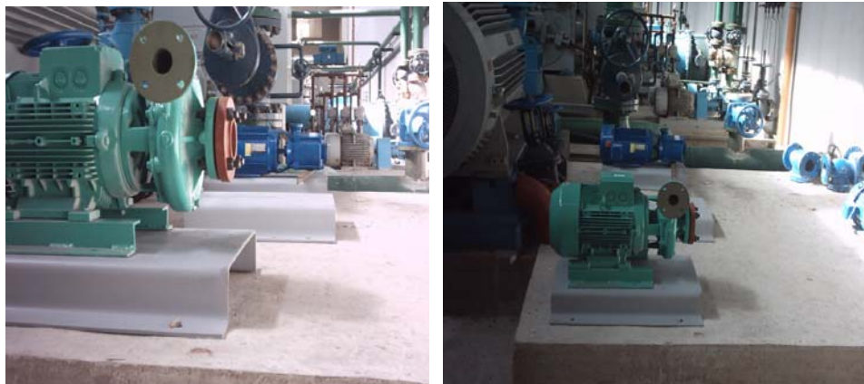
Figura 24. Bases para bombas de los sistemas diseñados
