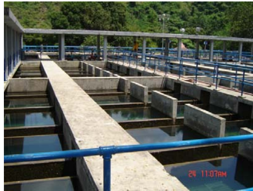
Figura 10. Conjunto de filtros
