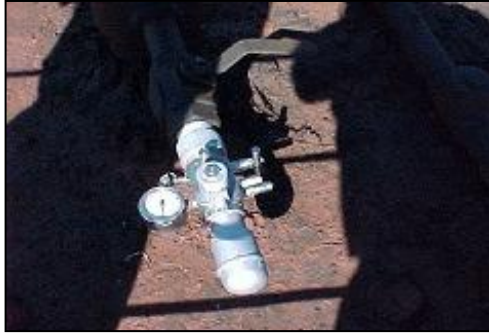
FIGURA 13. Dispositivo de disparo conectado a la válvula anular.
