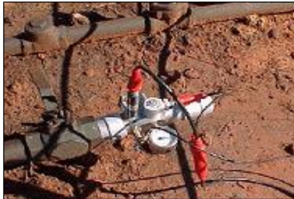
FIGURA 14. Dispositivo de disparo conectado a la válvula anular enlazado con el analizador.
